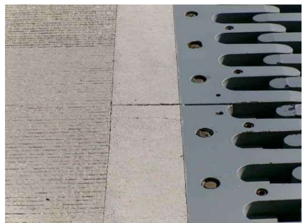
P8 후타재 균열( C_w=0.3\text{mm} 미만)
