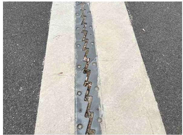
신축이음 A2 후타재 균열( Cw=0.3\text{mm} 미만)
