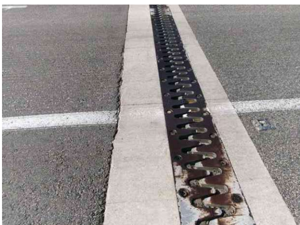
A1 후타재 균열(Cw=0.3mm미만)
