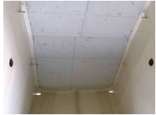
바닥판 하면 S1 망상균열(1.5 × 3.0)
