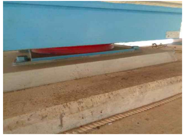
P1-Sh2 무수축물탈 균열 (0.1mm/0.2m×8EA)
