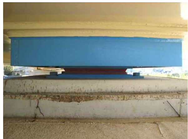
P5-Sh2 받침몰탈 균열(Cw=0.3mm미만)
