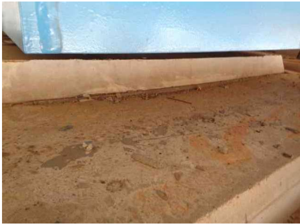
P5-Sh8 받침물탈 균열 (0.1mm/0.2m×2EA)
