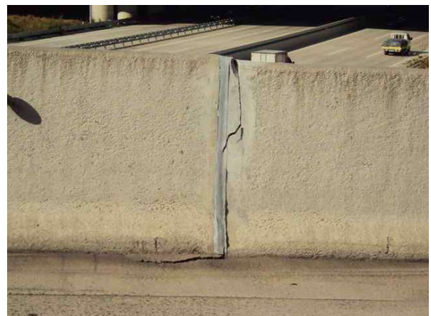
방호벽 S1(A1) 접속부 파손(0.2×1.0)
