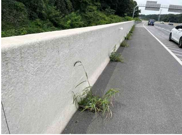
배수시설 S1 배수구 토사퇴적
