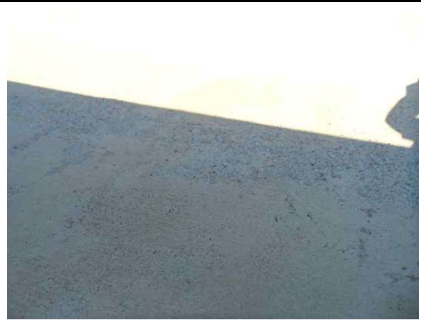
교면포장 S4 접속도로 포장박리(2.5×5.0)
