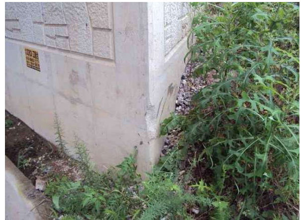
교대 A1 파손(0.2×0.3)
