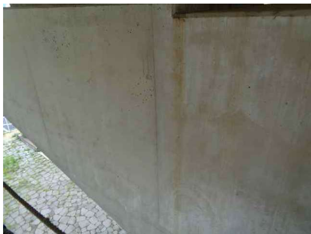
P6 코평부 균열(Cw=0.3mm미만)
