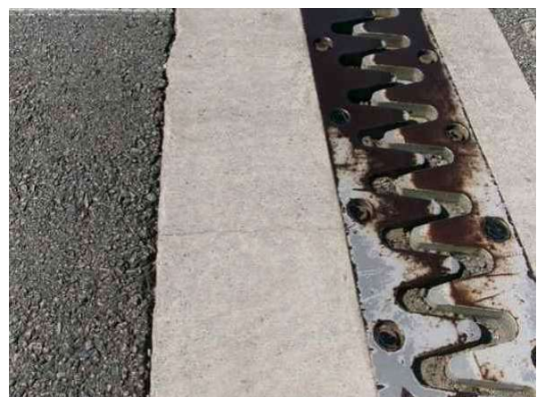
A1 후타재 균열(Cw=0.3mm미만)
