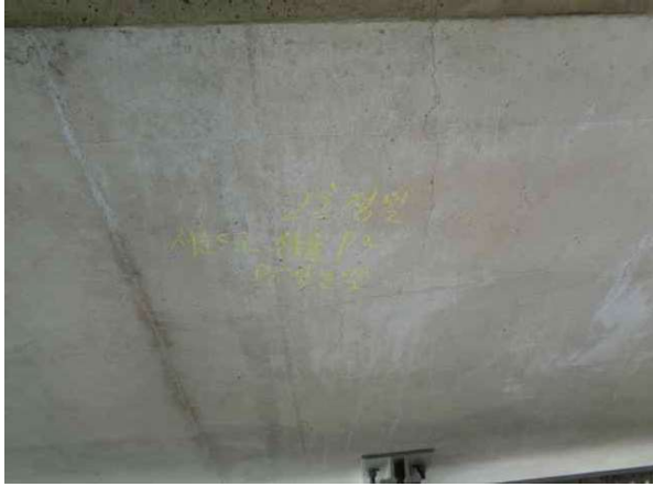
P2 콘크리트 망상균열 (6.0m×1.0m)
