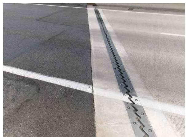
A2 후타재 균열(Cw=0.3mm미만)-서울방향
