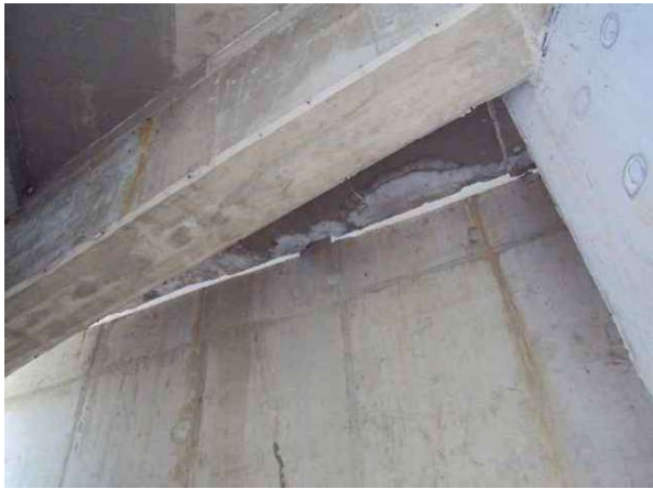
바닥판하면 S1 파손 (0.1×0.2)
