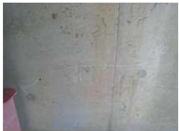
A2 균열(폭 0.2mm/1.0m)
