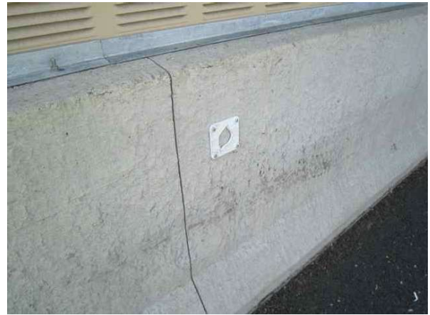
방호벽 S1 텔리네이트 파손(1EA)
