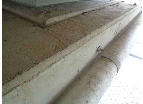
교각 P2 코핑부 균열(Cw=0.3mm이상)
