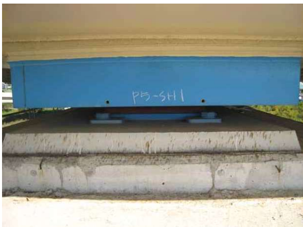
P5-Sh1 받침몰탈 균열(Cw=0.3mm미만)
