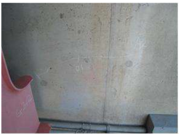
A2 균열(폭 0.2mm/1.0m)
