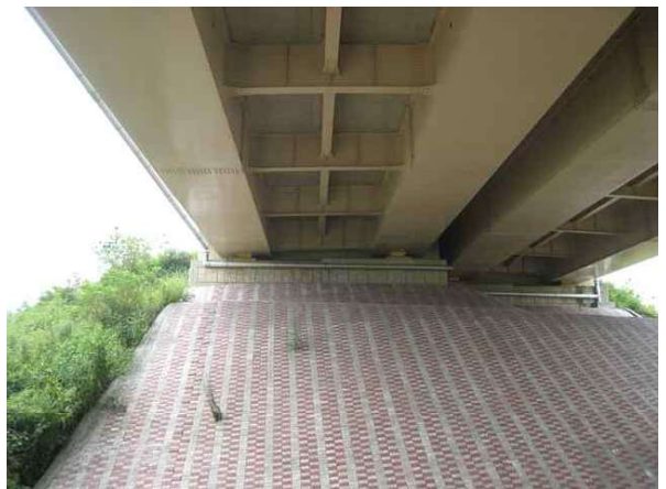
A1 교대 상태양호
