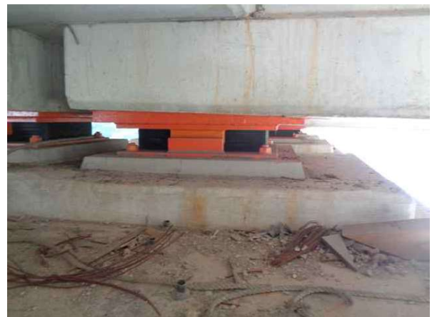
P1-Sh11 무수축물탈 균열 (0.1mm/0.2m)
