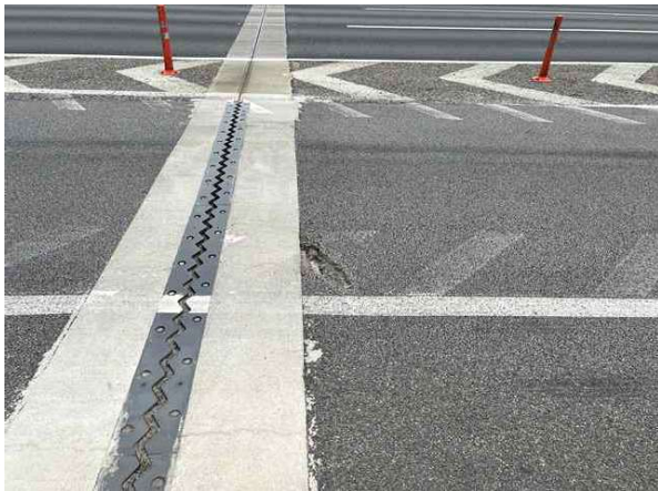
교면포장 S2 접속도로 아스콘 파손 (0.2×0.5)
