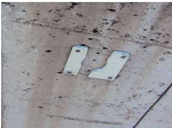
방호벽 S1 텔리네이트 파손(1EA)
