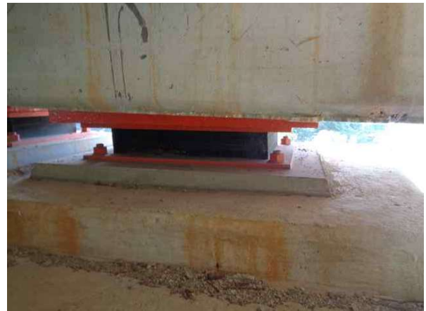
P1-Sh8 무수축물탈 균열 (0.1mm/0.2m)
