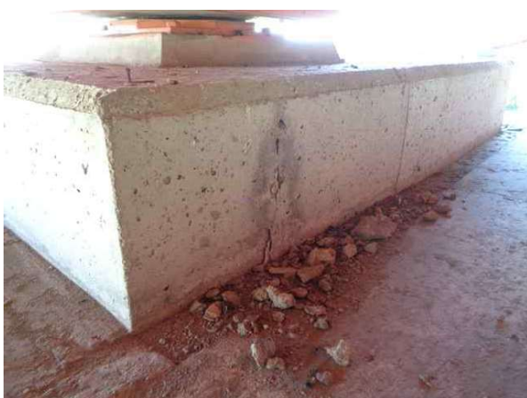
P35-Sh1 받침콘크리트 파손 (0.1m×0.3m×2EA)
