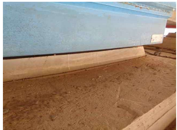
P5-Sh8 받침물탈 균열 (0.1mm/0.2m×2EA)
