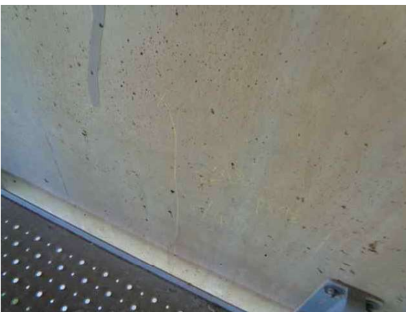
P3 코평부 균열(Cw=0.3mm미만)
