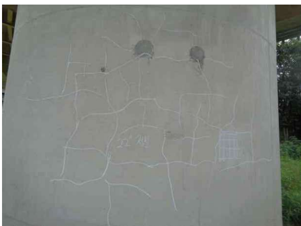
P1 기둥부 망상균열(8.0 × 2.0)
