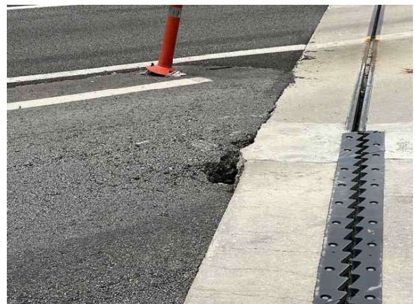
교면포장 S1 접속도로 아스콘 파손( 0.3 \times 1.0 )
