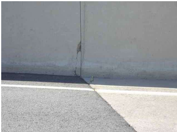
교면포장 S1 접속부아스콘 파손(0.2m×1.0m)-문산방향
