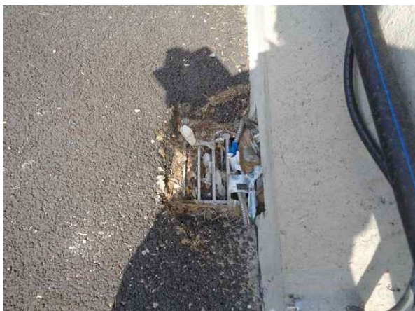
배수시설 S3 배수구 토사퇴적
