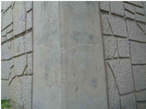
A1 구체 균열(Cw=0.3mm미만)
