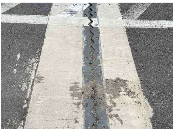
신축이음 A1 후타재 균열(Cw=0.3mm미만)
