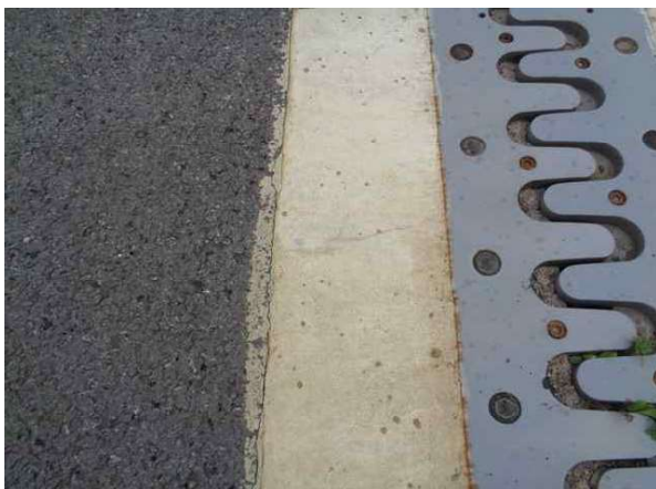
신축이음 A1 후타재 균열(Cw=0.3mm미만)
