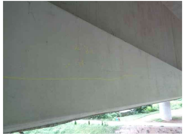
거더 S2 G4 균열(Cw=0.3mm미만)
