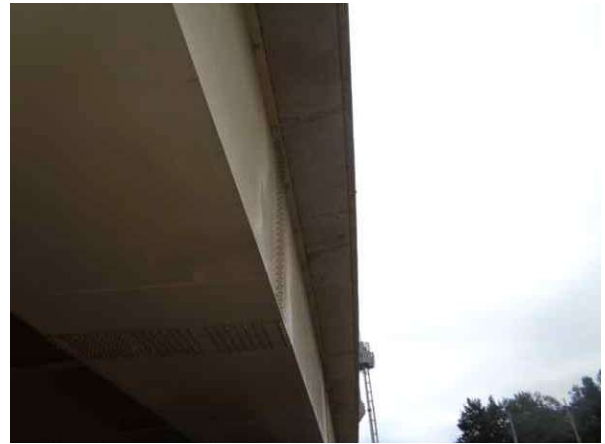
바닥판 하면 S1 캔틸레버부 상태 양호
