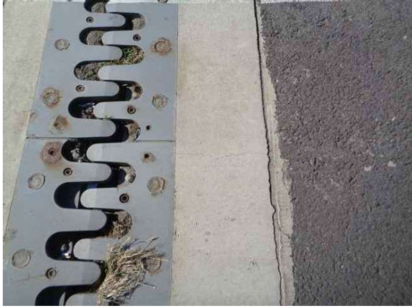
A2 후타재 균열 (0.2mm/0.3m×10EA)
