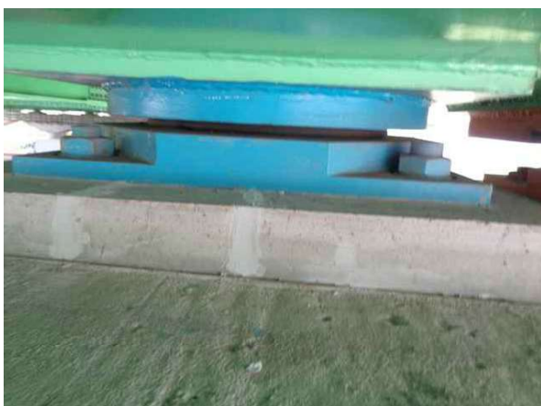
교량받침 P2-Sh1 받침물탈 균열( C_w=0.3\text{mm} 미만)
