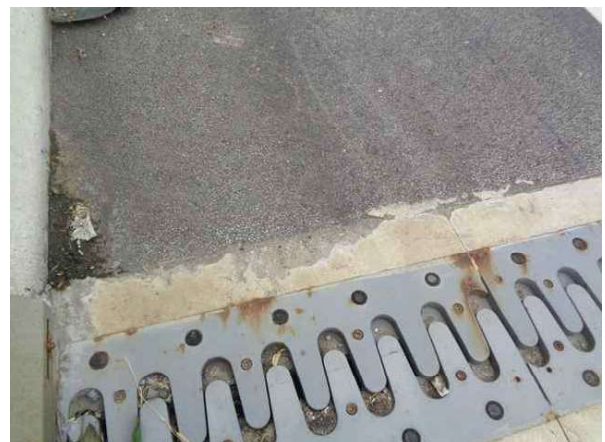
신축이음 A2 후타재 파손(0.1×3.0×2EA)
