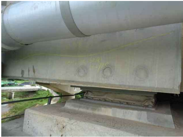
거더 S2 G1 균열(Cw=0.3mm미만)
