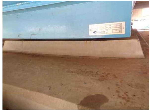
P5-Sh4 받침물탈 균열 (0.1mm/0.2m×2EA)
