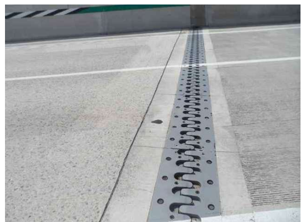
신축이음 A1 후타재 균열(Cw=0.3mm미만)
