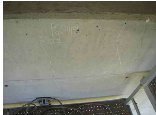
STB-P6 코핑부 균열(Cw=0.3mm미만)
