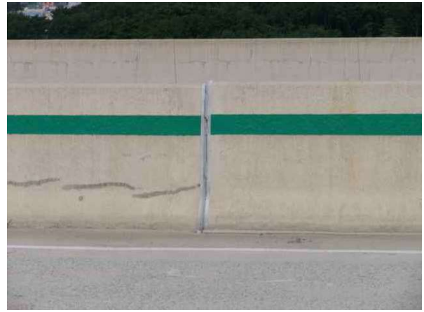
S1 접속부 실란트 파손
