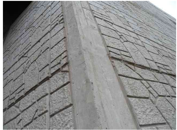
A1 보수부 재균열(Cw=0.3mm미만)-서울방향
