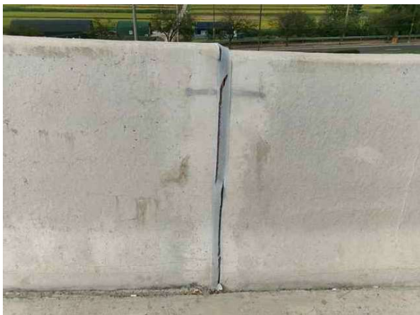
방호벽 S4 실란트파손(L=1.5m)
