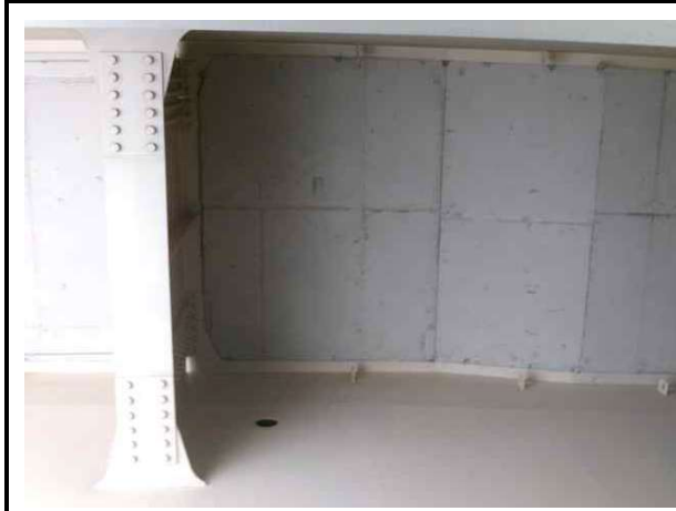
바닥판 하면 S1 망상균열(1.5 × 2.0)
