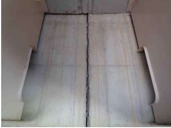
A1 실란트 파손(6.0m) - 금회
