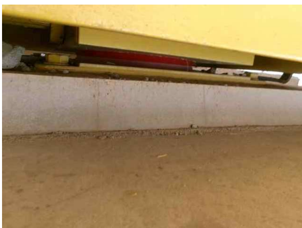
P3-Sh8 받침물탈 균열 (0.2mm/0.2m×2EA)
