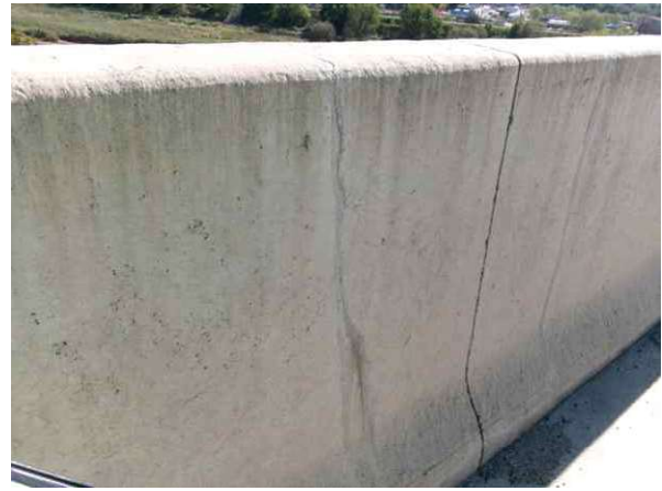
S16 방호벽 균열(Cw=0.3mm미만)
