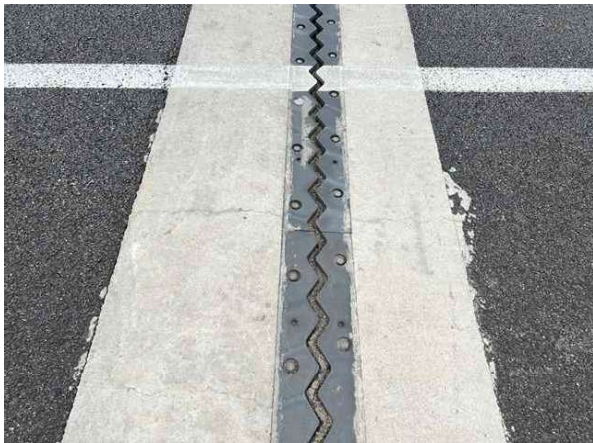
신축이음 A1 후타재 균열(Cw=0.3mm미만)
