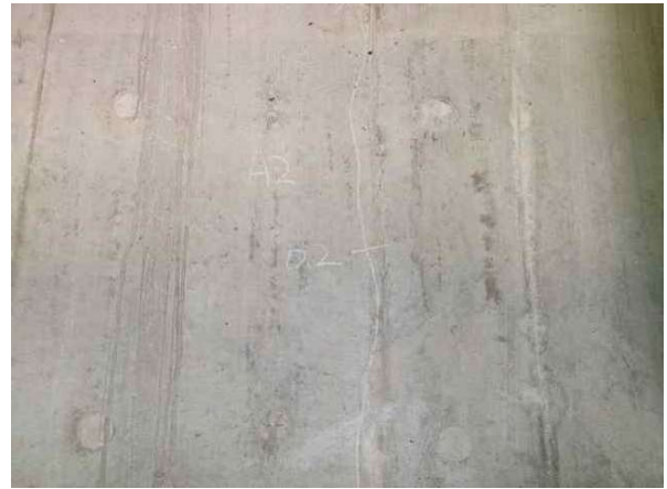
교대 A2 흠벽 균열( Cw=0.3\text{mm} 미만)
