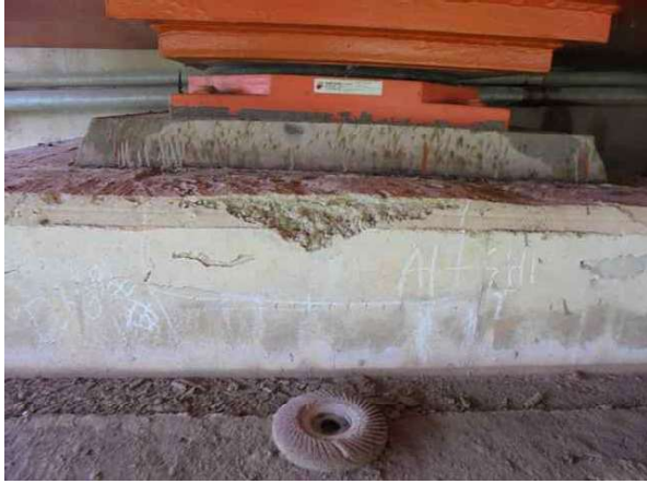
A1-Sh1 받침콘크리트 재료분리 (0.1m×0.2m)-금회
