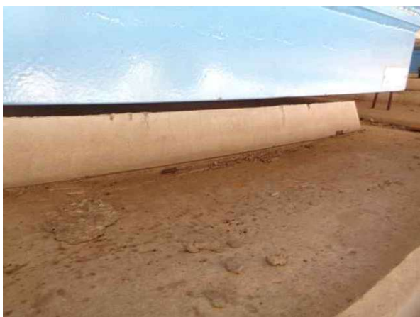
P5-Sh10 받침물탈 균열 (0.1mm/0.2m×2EA)
