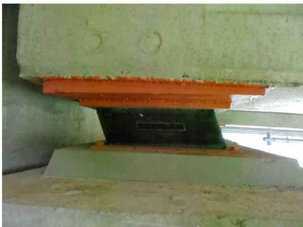
A2-Sh2 받침콘크리트 파손(0.1×0.1)
