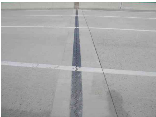
A1 후타재 균열 (Cw=0.3mm미만)
