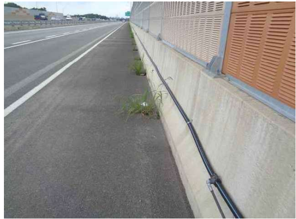
배수시설 S2 배수구 토사퇴적
