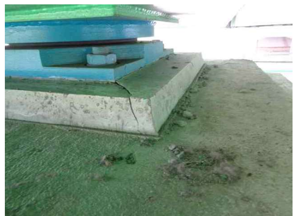
교량받침 P2-Sh1 받침물탈 파손( 0.2 \times 1.0 )
