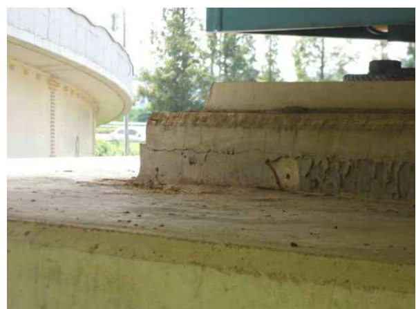
P1-Sh1 받침콘크리트 균열(Cw=0.3mm미만)
