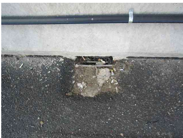
배수시설 S3 배수구 토사퇴적
