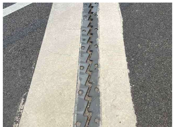
신축이음 A1 후타재 균열(Cw=0.3mm미만)
