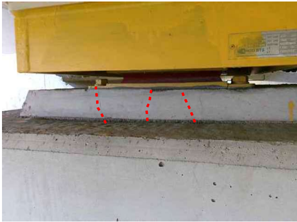
P12-Sh1 받침물탈 균열( C_w=0.3\text{mm} 미만)
