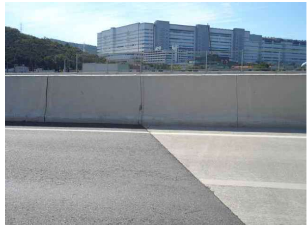
교면포장 S1 접속부아스콘 파손(0.2m×1.0m)-문산방향
