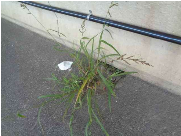
배수시설 S1 배수구 토사퇴적
