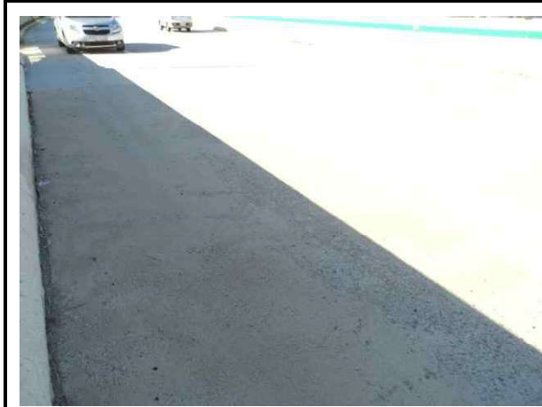
교면포장 S4 접속도로 포장박리(2.5×5.0)
