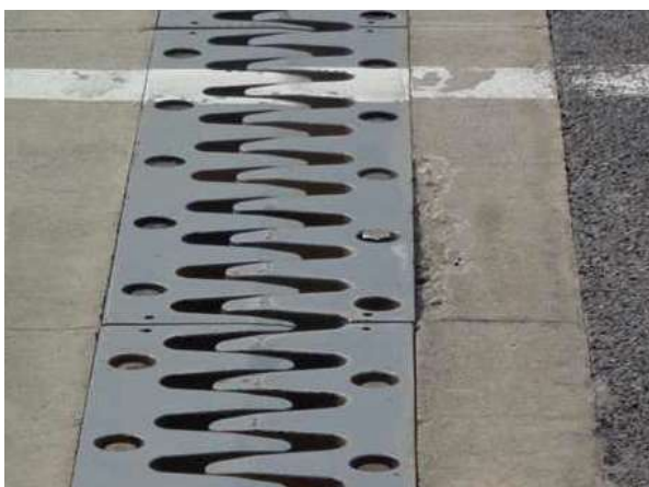
A1 후타재 파손 (0.2m×0.5m) - 22년 상반기
