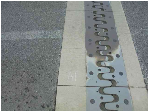
A1 후타재 균열 (0.3mm/0.25m×4EA)
