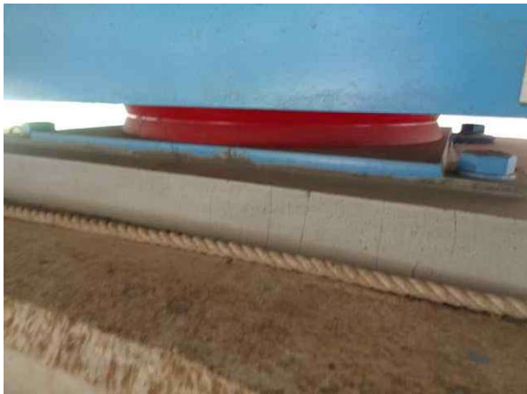
P1-Sh3 무수축물탈 균열 (0.1mm/0.2m×8EA)
