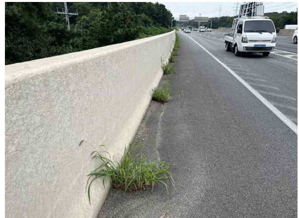
배수시설 S2 배수구 토사퇴적
