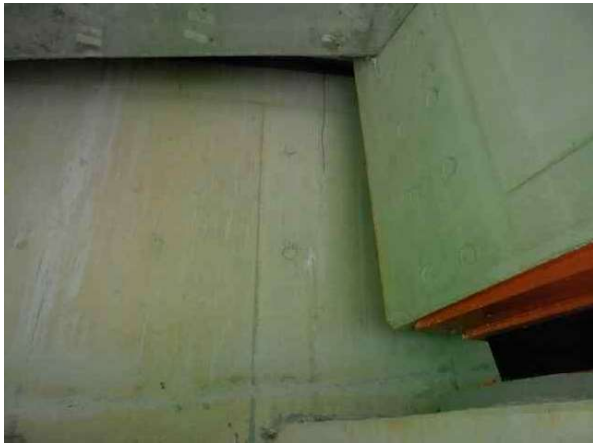
교대 A1 흠벽 균열( Cw=0.3\text{mm} 이상)
