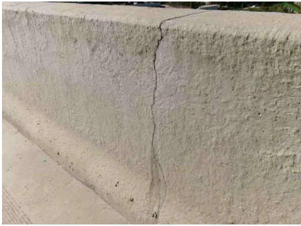
S15 방호벽 균열(Cw=0.3mm이상)
