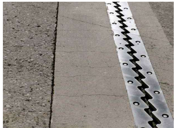
A1 후타재 균열 ( Cw=0.3mm 미만)
