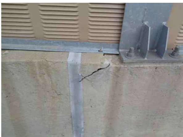
방호벽 S1 접속부 파손(0.2×0.2)
