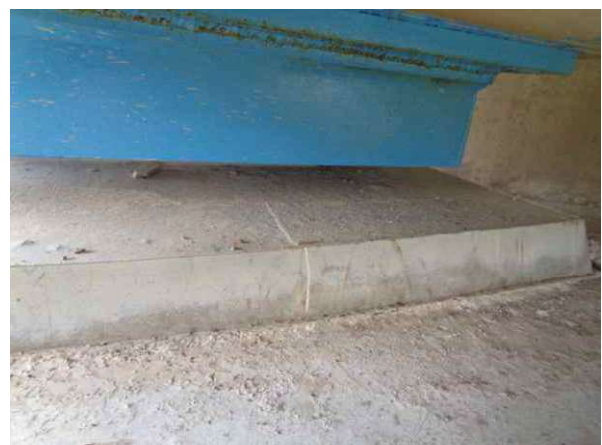
A1-Sh7 받침물탈 균열( C_w=0.3\text{mm} 미만)
