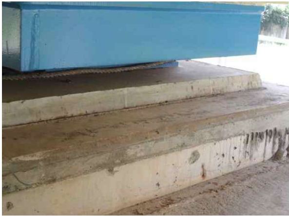
P1-Sh1 받침몰탈 균열(Cw=0.3mm미만)
