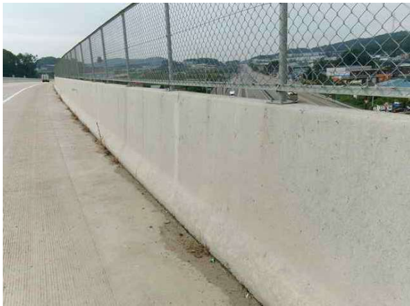
방호벽 S1 균열(Cw=0.3mm미만)
