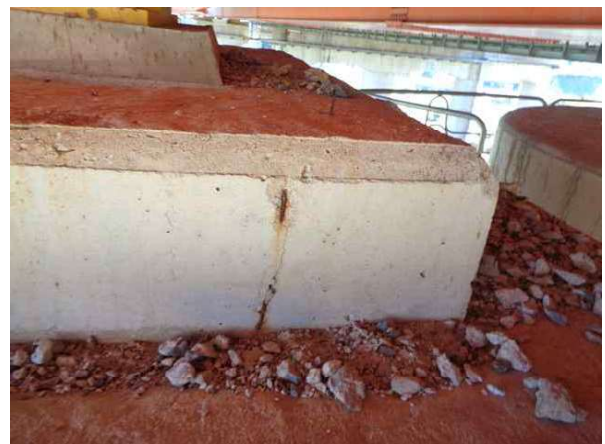
P1-Sh1 받침콘크리트 파손 (0.1m×0.3m)
