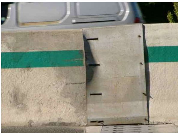
신축이음 A2 차수판 파손
