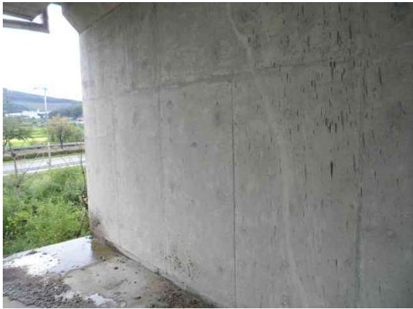
교대 A2 망상균열(3.0×2.0)
