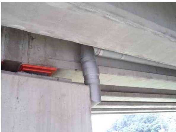
배수시설 S13 배수관 이음부 불량(1EA)
