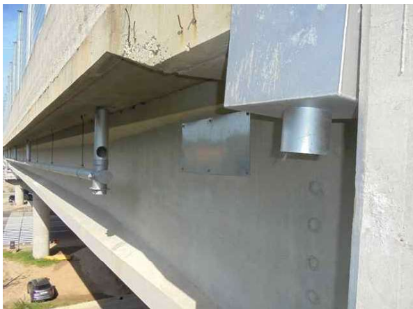
S1 A1측 배수관 탈락
