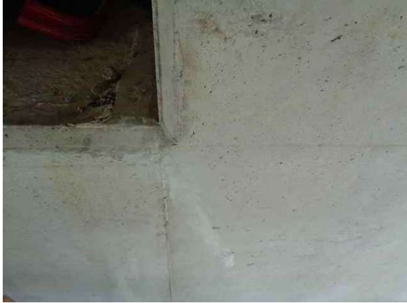
교각 P2 코핑부 균열(Cw=0.3mm이상)
