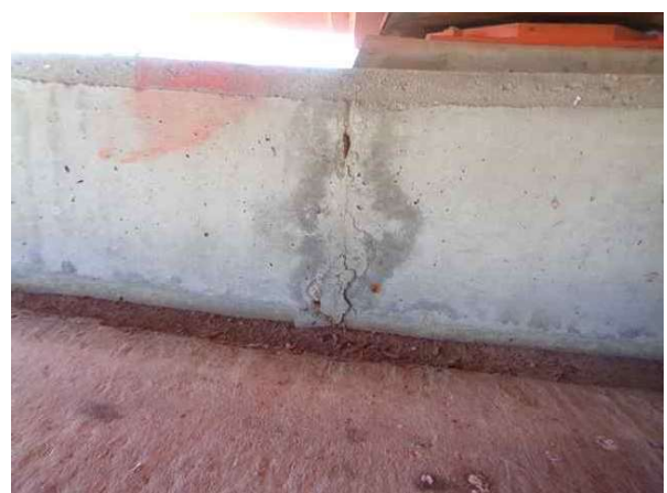
P35-Sh1 받침콘크리트 파손 (0.1m×0.3m×2EA)
