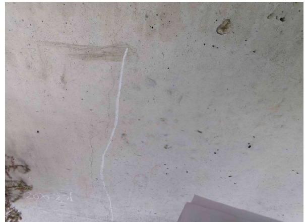
교각 P2 코핑부 균열( Cw=0.3\text{mm} 이상)
