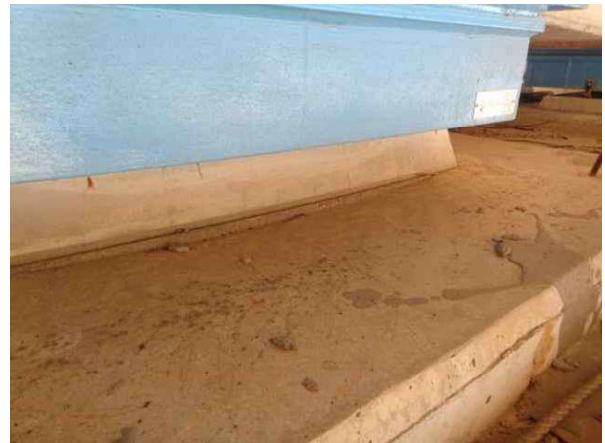
P5-Sh9 받침물탈 균열 (0.1mm/0.2m×2EA)
