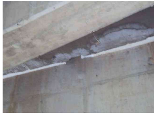
바닥판하면 S1 파손 (0.1×0.2)
