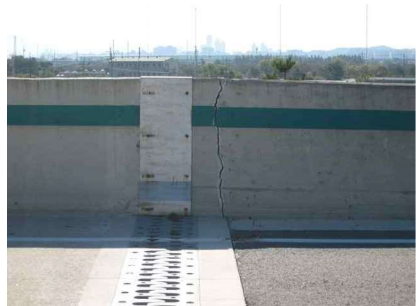
S1 중분대 접속부 A1측 파손
