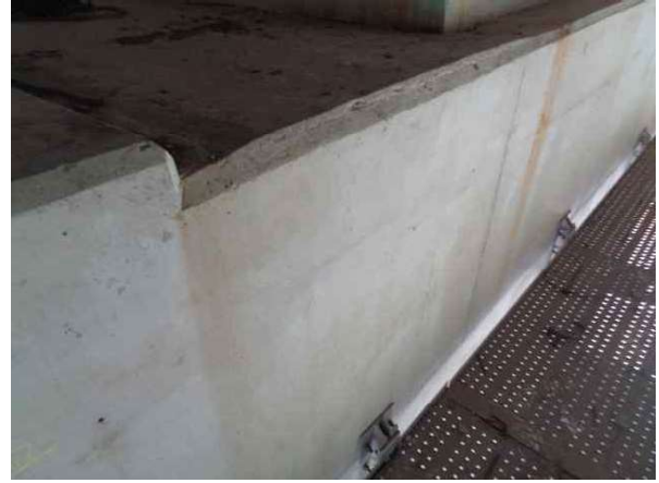
P2 콘크리트 망상균열 (8.0m×1.0m)
