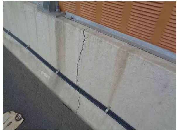
방호벽 S4 접속부 파손(0.1×1.5)
