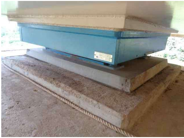
P1-Sh1 무수축물탈 균열 (0.1mm/0.2m×8EA)
