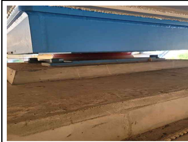
P1-Sh3 받침물탈 균열 (0.2mm/0.4m×4EA)
