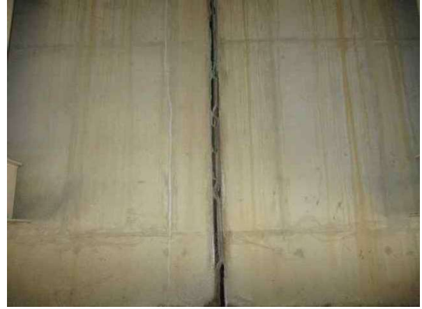
A1 실란트 파손(6.0m) - 22년 상반기
