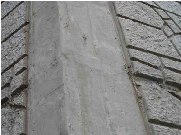
A1 보수부 재균열(Cw=0.3mm미만)-서울방향
