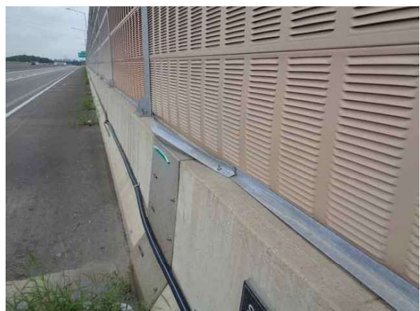
방호벽 S1 방음벽 파손(1EA)
