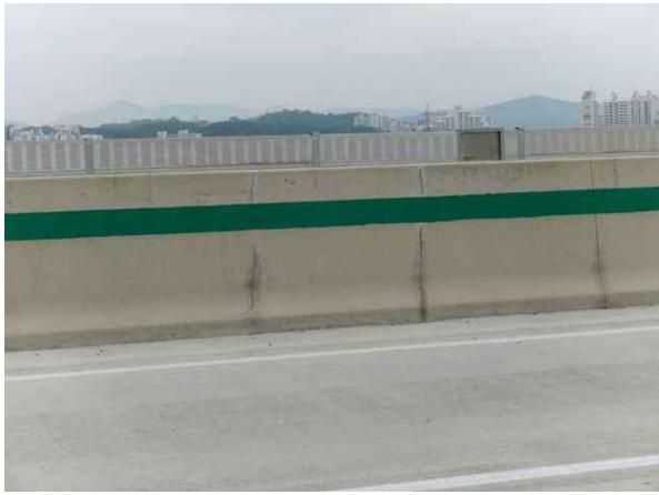
S4 중앙분리대 균열부 백태(0.2×1.0×10EA)
