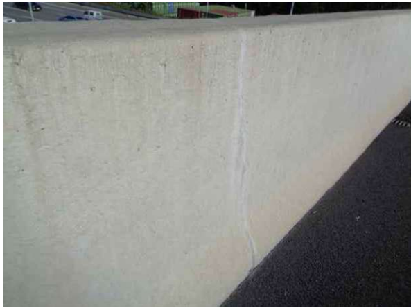
STB-S3 방호벽 균열(Cw=0.3mm미만)
