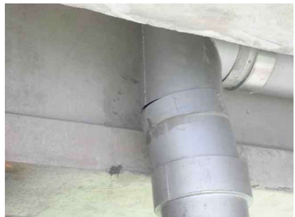
배수시설 S13 배수관 이음부 불량(1EA)
