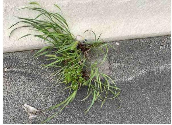
배수시설 S1 배수구 토사퇴적
