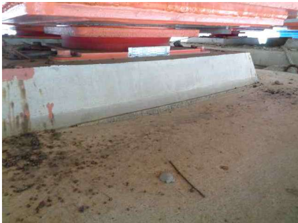
P5-Sh6 받침물탈 균열 (0.1mm/0.2m×2EA)
