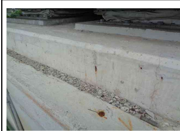
P2-Sh1 받침콘크리트 균열( Cw=0.3\text{mm} 미만)
