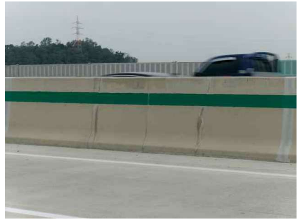
S6 중앙분리대 균열부 백태(0.1×1.0×8EA)
