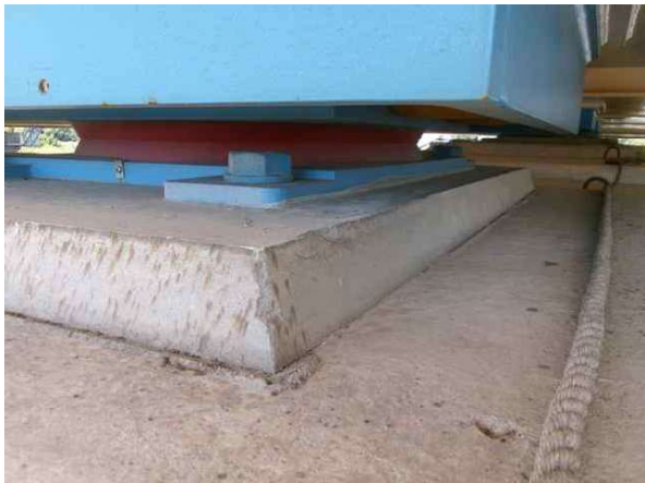
P2-Sh1 받침물탈 파손 (0.1m×0.1m)
