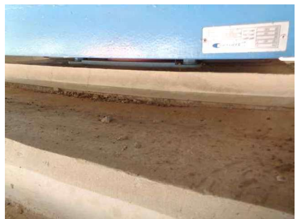
P5-Sh11 받침물탈 균열 (0.1mm/0.2m×2EA)
