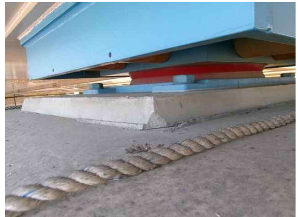
P2-Sh3 받침물탈 파손 (0.1m×0.1m)
