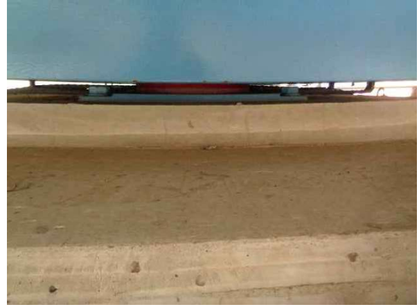
P5-Sh4 받침물탈 균열 (0.1mm/0.2m×2EA)
