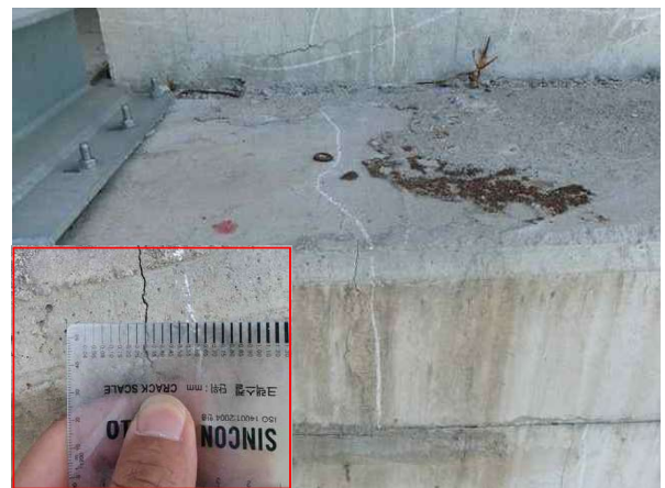
P4 코핑부 균열(Cw=0.3mm이상)
