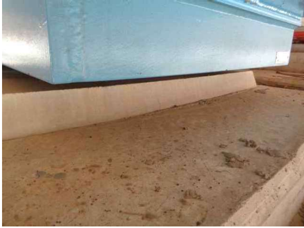
P5-Sh5 받침물탈 균열 (0.1mm/0.2m×2EA)
