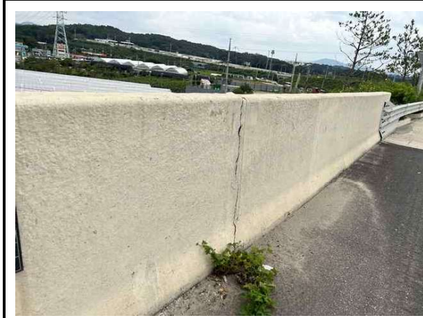
방호벽 S1 접속부 파손(0.2×1.5)
