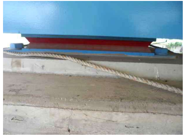
P1-Sh2 받침몰탈 균열(Cw=0.3mm미만)
