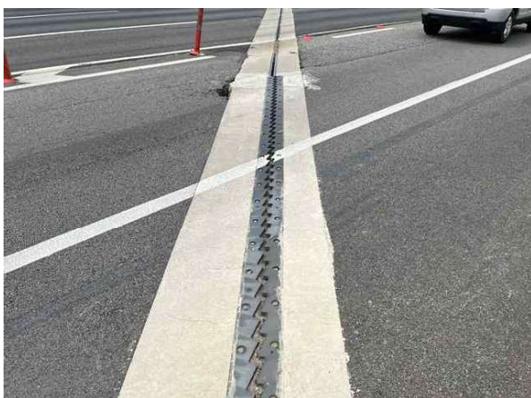
신축이음 A1 후타재 균열(Cw=0.3mm미만)
