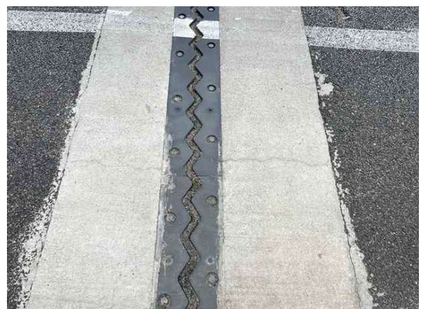
신축이음 A2 후타재 균열(Cw=0.3mm미만)
