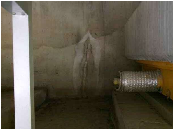
교대 A2 흠벽 균열부백태(0.2×0.5)
