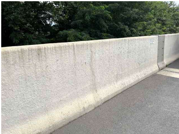
방호벽 S2 접속부 파손(0.1×1.5)
