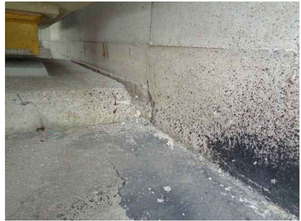
교대 A2 파손(0.1×0.1)
