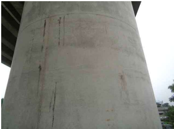
교각 P1 기둥부 균열( Cw=0.3\text{mm} 미만)
