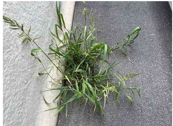
배수시설 S1 배수구 토사퇴적
