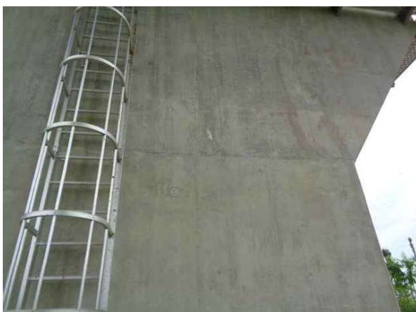
교각 P3 균열부백태(0.2×0.4)
