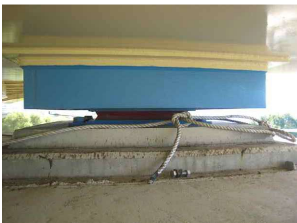
P7-Sh1 받침몰탈 균열(Cw=0.3mm미만)
