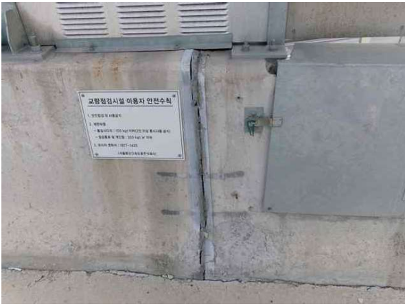
S1 접속부 실란트 파손
