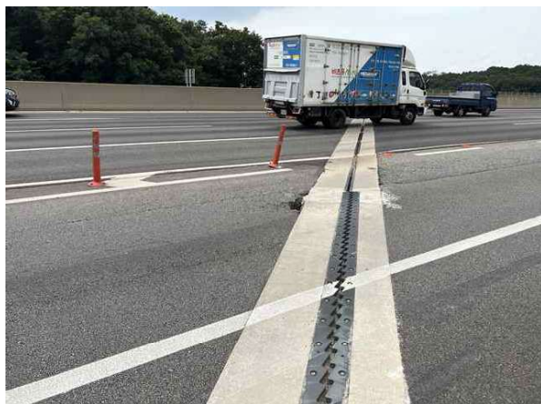
교면포장 S1 접속도로 아스콘 파손( 0.3 \times 1.0 )
