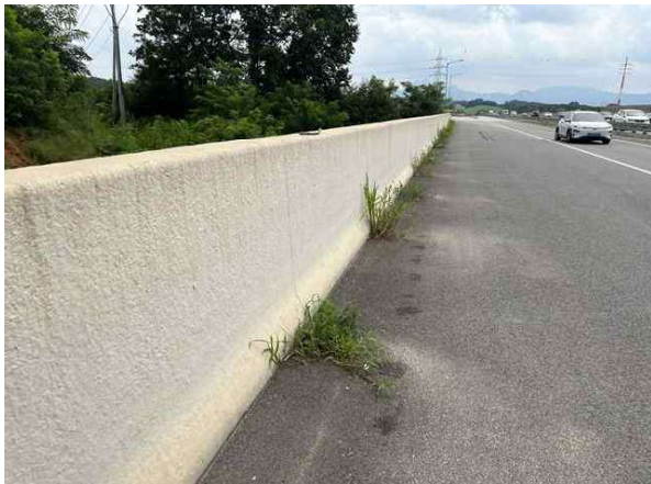
배수시설 S1 배수구 토사퇴적
