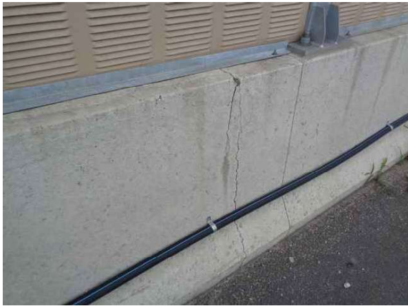
방호벽 S1 접속부 파손(0.1×1.5)
