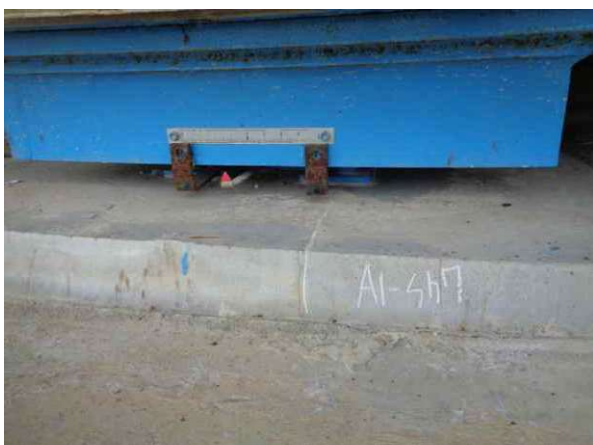
A1-Sh7 받침물탈 균열( C_w=0.3\text{mm} 미만)
