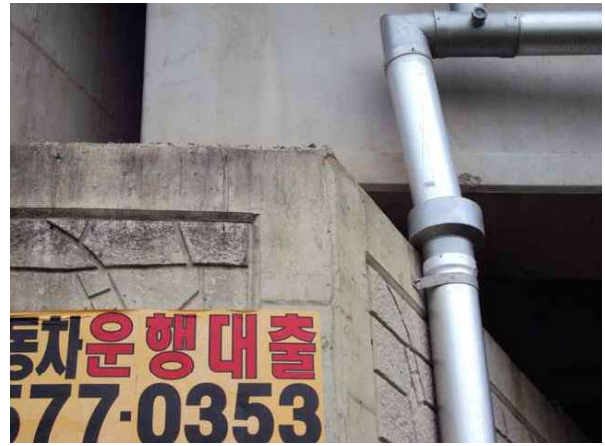
교대 A2 망상균열(0.4×0.3)
