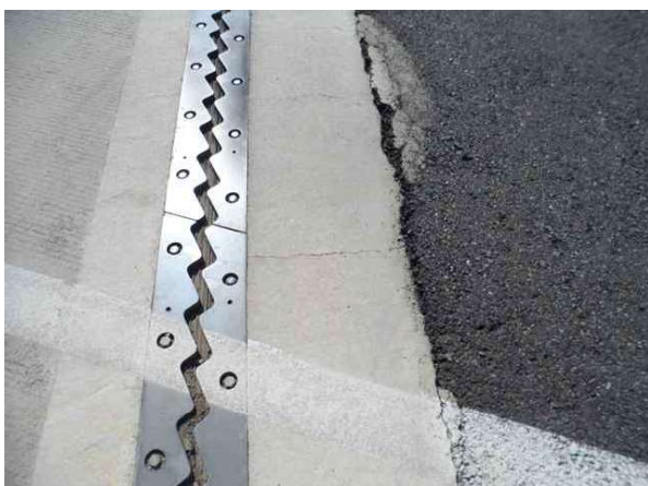
A2 후타재 균열(Cw=0.3mm미만)-문산방향
