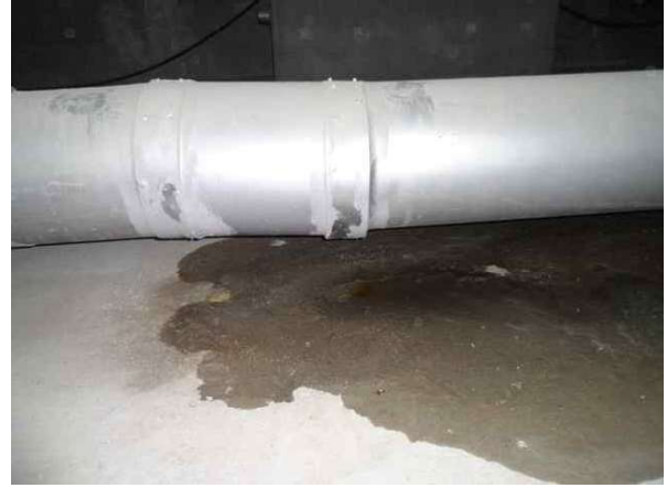
배수시설 S4 배수관 누수 1EA
