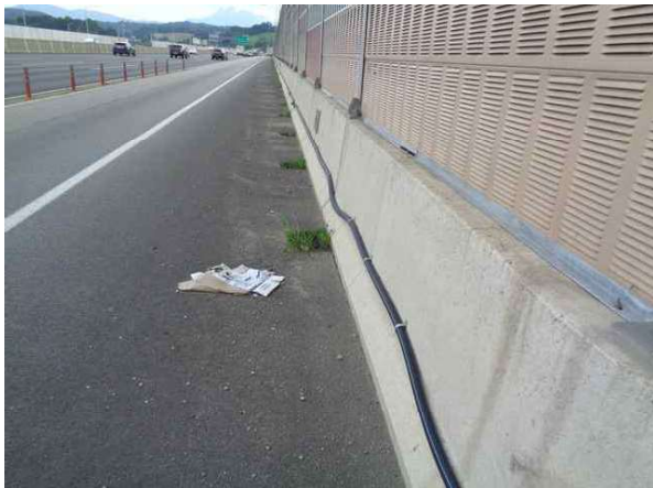
배수시설 S1 배수구 토사퇴적
