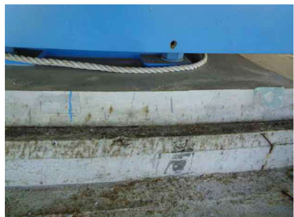
P7-Sh1 받침몰탈 균열(Cw=0.3mm미만)
