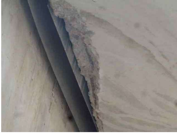
S4 파손 및 철근노출 (0.2m×1.0m)
