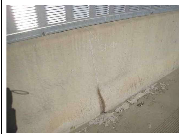
S1 방호벽 균열(0.2mm)
