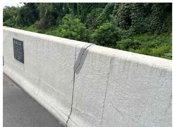
방호벽 S1 접속부 파손(0.1 × 1.5)
