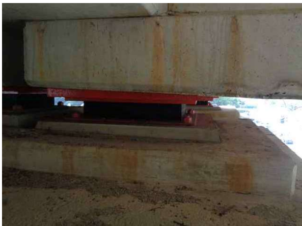
P1-Sh9 무수축물탈 균열 (0.1mm/0.2m)
