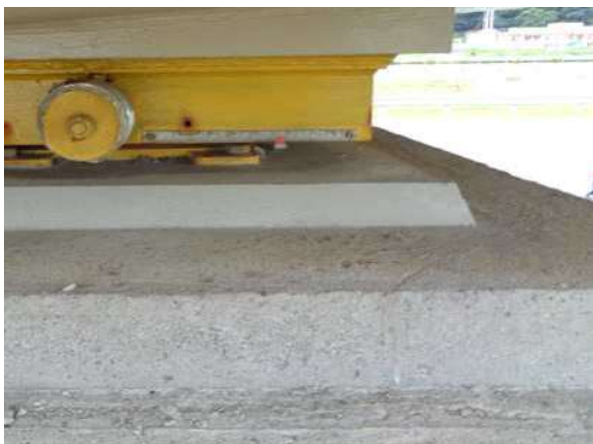
교량받침 A1-Sh2 받침콘크리트 재료분리 (0.3×0.3)
