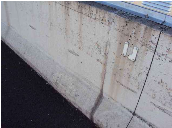
방호벽 S1 균열(Cw=0.3mm이상)
