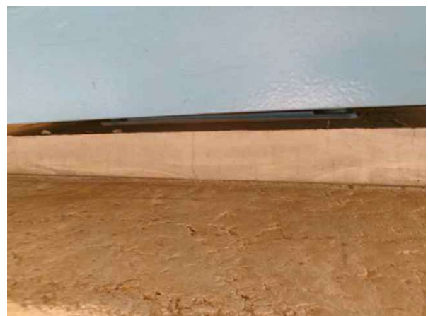
P4-Sh8 받침물탈 균열 (0.2mm/0.2m×2EA)
