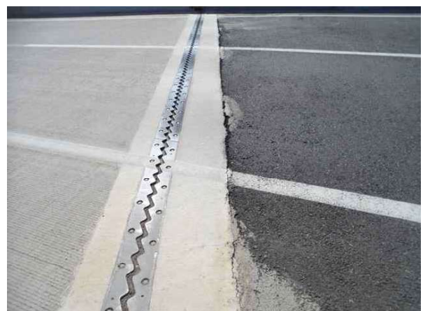
A2 후타재 균열(Cw=0.3mm미만)-문산방향
