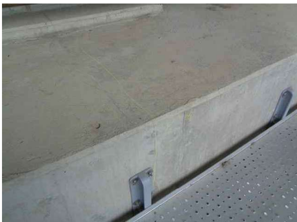
교각 P1 균열(Cw=0.3mm이상)
