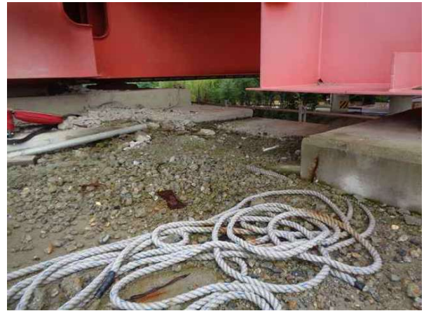
P2 코핑부 상면 폐코크리트 적치
