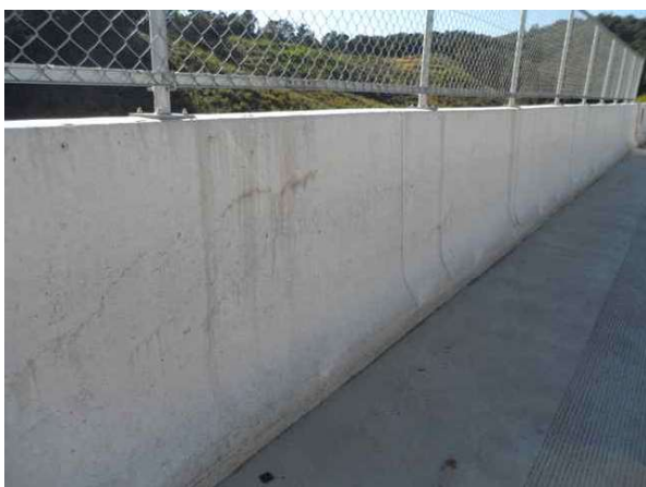
방호벽 S4 균열(Cw=0.3mm미만)
