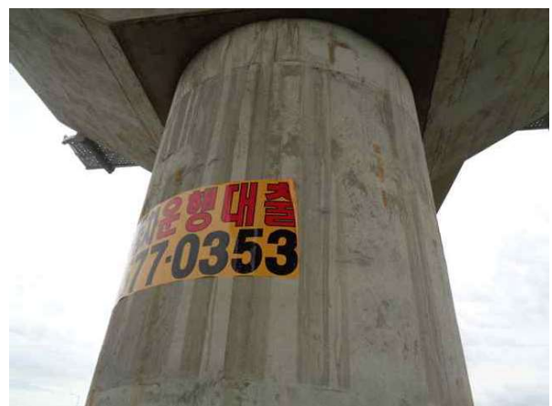
교각 P1 코핑부 파손(0.2×0.3)
