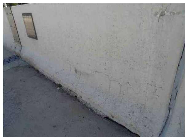
방호벽 S4 균열(Cw=0.3mm미만)
