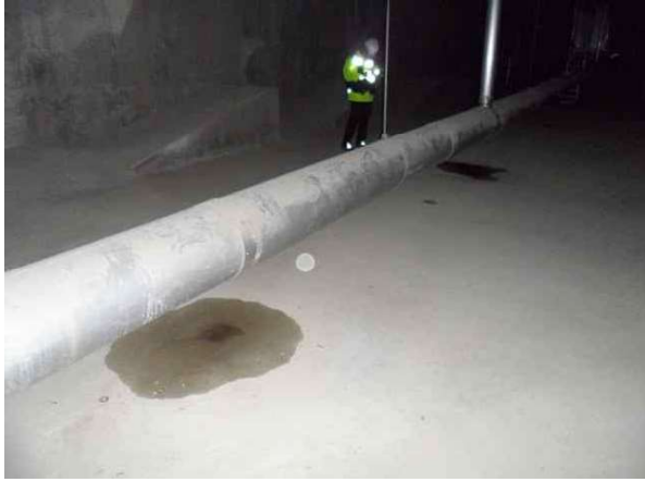
배수시설 S1 배수관 누수 3EA
