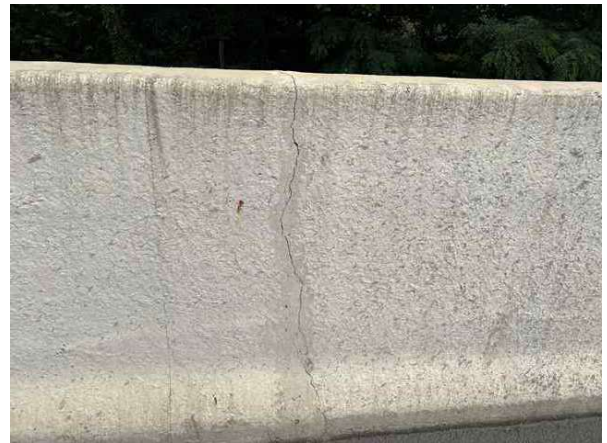
방호벽 S2 접속부 파손(0.1×1.5)
