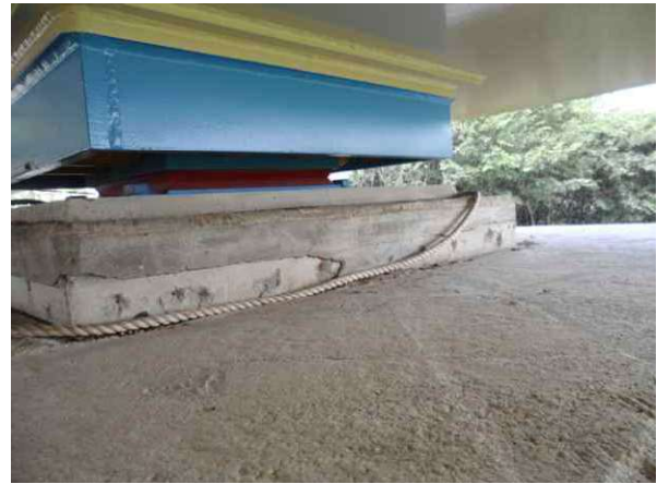
P1-Sh2 받침콘크리트 균열(Cw=0.3mm미만)
