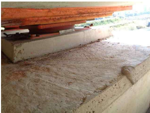
P5-Sh7 받침물탈 균열 (0.1mm/0.2m×2EA)
