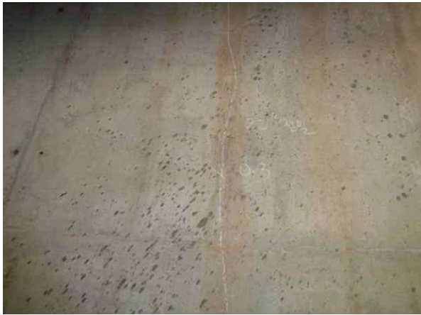
A1 흠벽 균열( C_w=0.3\text{mm} 이상)
