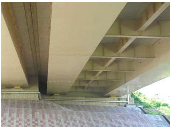
A1 교대 상태양호
