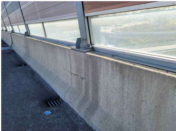
S4 균열 (0.2mm/1.5m×17EA)
