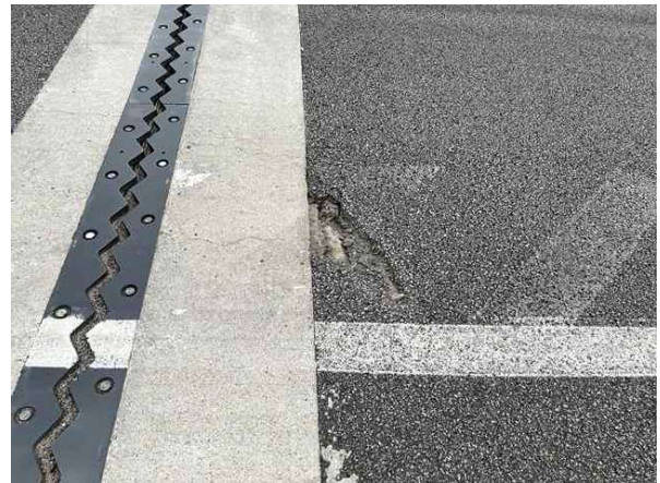
교면포장 S2 접속도로 아스콘 파손 (0.2×0.5)
