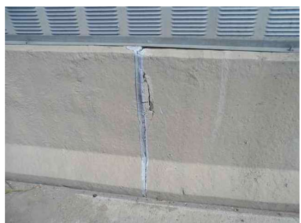
S2 접속부 방호벽 파손(0.1×1.5)
