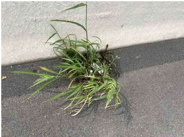
배수시설 S2 배수구 토사퇴적
