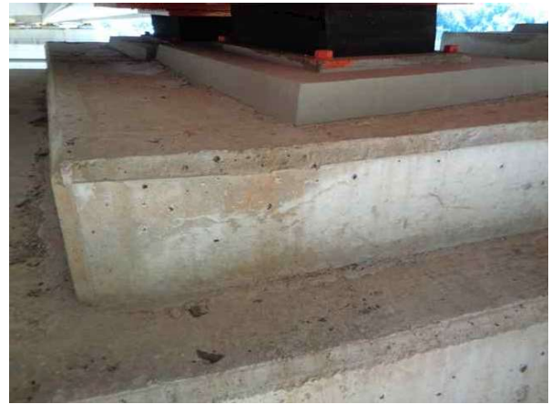
P6-Sh11 받침콘크리트 균열(Cw=0.3mm미만)
