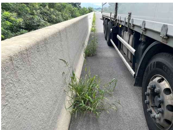
배수시설 S2 배수구 토사퇴적
