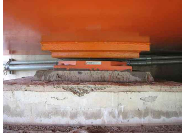
A1-Sh1 받침콘크리트 재료분리 (0.1m×0.2m)-21년 하반기
