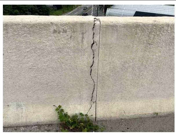
방호벽 S1 접속부 파손(0.2×1.5)
