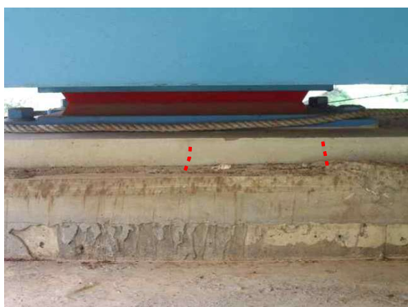
P1-Sh1 받침물탈 균열(Cw=0.3mm미만)
